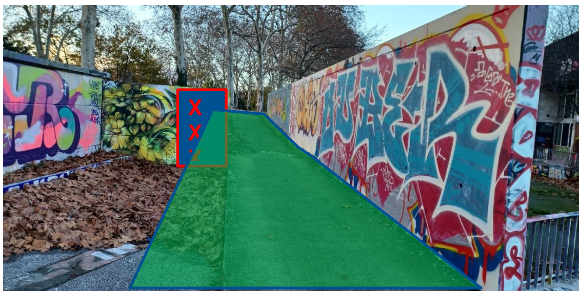
Figure 18 : Exemple de reprise du plan incliné. Mur arasé et plan incliné élargi
