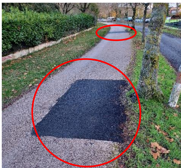
Figure 15 : 2 réparations de fortune dangereuses
